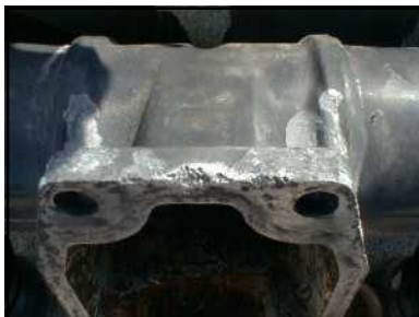
マニホールド・フランジ部の電蝕。
